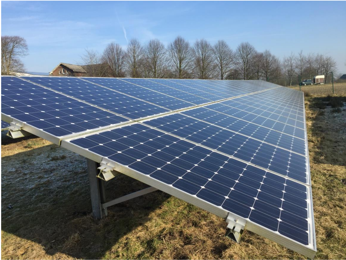
Abbildung 11: Beispiel einer PV-Freiflächenanlage mit 2 senkrechten Modulreihen
